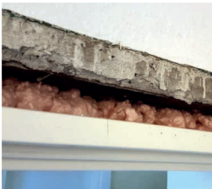
En karm monteret med PU-skum og for stor fugebredde.
