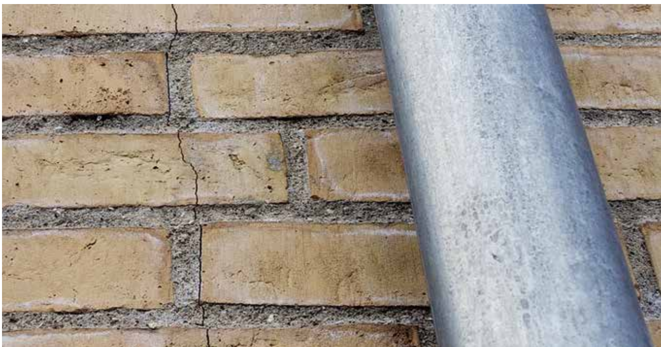
En lodret revne i en formur ved et murhjørne, hvor der er placeret bindere tæt ved hjørnet. Foto BYG-ERFA
