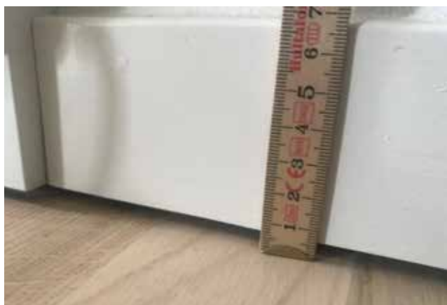
Sætning i gulvkonstruktion med EPS-beton.
