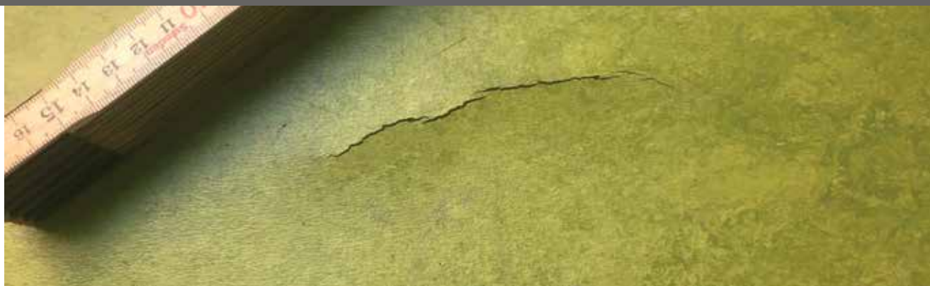
Nedbrudt/revnet gulvbelægning efter sætning i EPS-beton.
