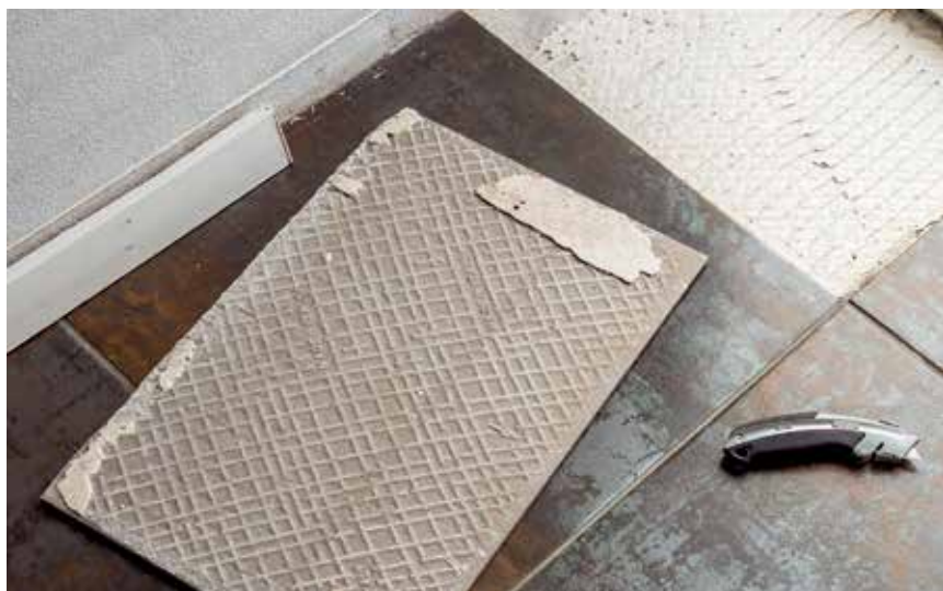
Manglende vedhæftning på bagside af storformatflise pga. for ringe fasttrykning, og/eller fordi klæberens har ‘trukket skind’.
