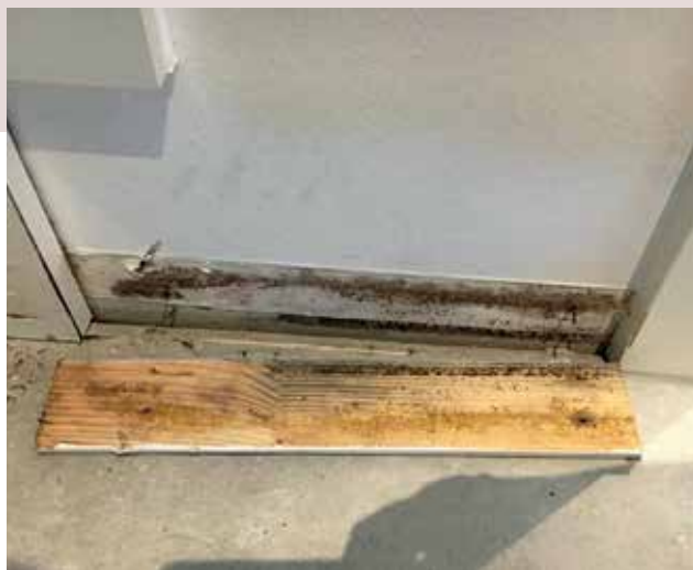
Skimmelsvampevækst på gipsplader, der er opfugtet af kontakt med fugtig beton.
