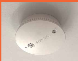
Figur 2. Røgalarm monteret på loft med skjult kabling.
