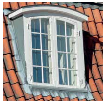
Blyinddækning omkring kvist på fredet bygning.
