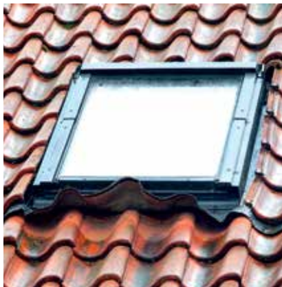
Inddækning af plisseret zink under ovenlys. Inddækningen har løftet sig efter vindpåvirkning.
